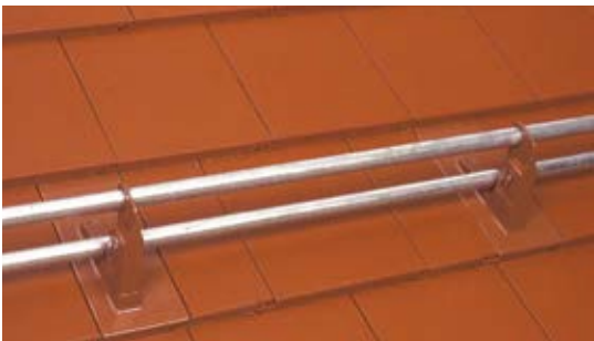
Sicher ist sicher: die Schneefangsicherung
