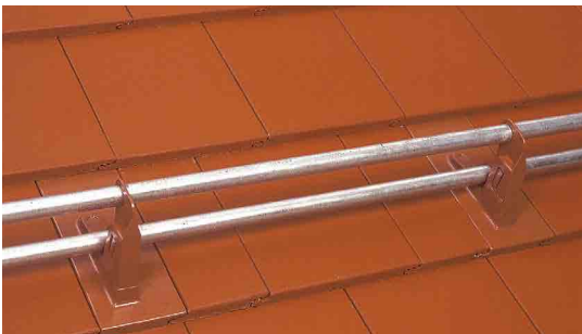
Sicher ist sicher: die Schneefangsicherung
